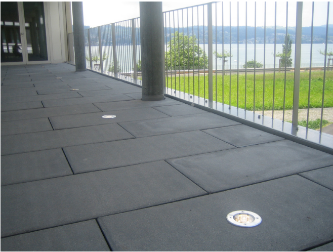
VisuLED HOME nel pavimento di pietra con anello sopra muro
